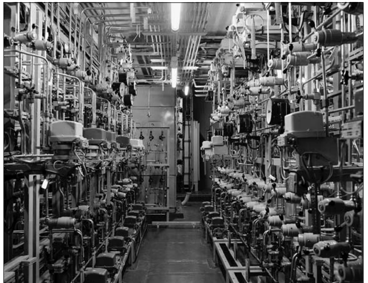
Druckmessgeräte im Block 6: Wer hier arbeitete, musste Russisch können.
